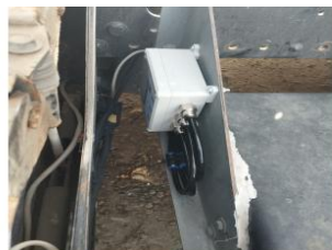
CONEXIÓN TUBOS DE AIRE
