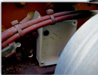
Instalación caja sensores
